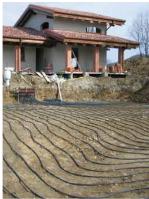
Impianto geotermico orizzontale nel Comune di Settimo Rottaro (TO) (Foto pubblicata sul rapporto "Comuni Rinnovabili 2010")
